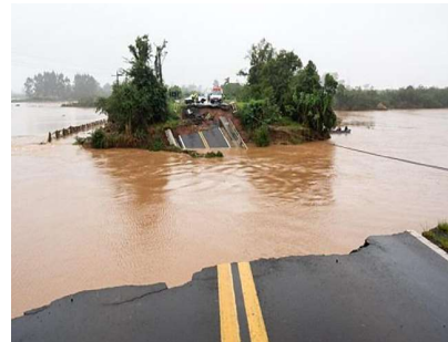
Estradas e pontes não suportaram o volume e a força da água dos rios e das chuvas
